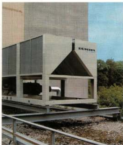
Aus Platzgründen wurde die Klimaanlage auf dem Dach installiert
